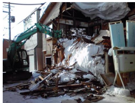
積雪による空家等の倒壊事例
