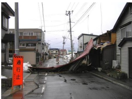
屋根の飛散事例
